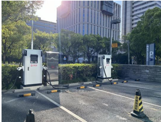
いつの間にか設置されていた充電装置 (当事務所が入っているビル敷地内)
