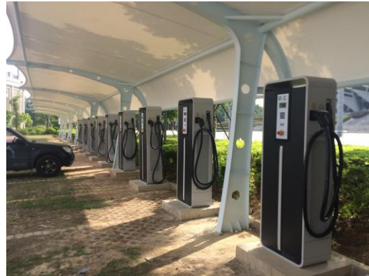
スラリとならぶ充電装置 (事務所スタッフが住むマンション敷地内)
